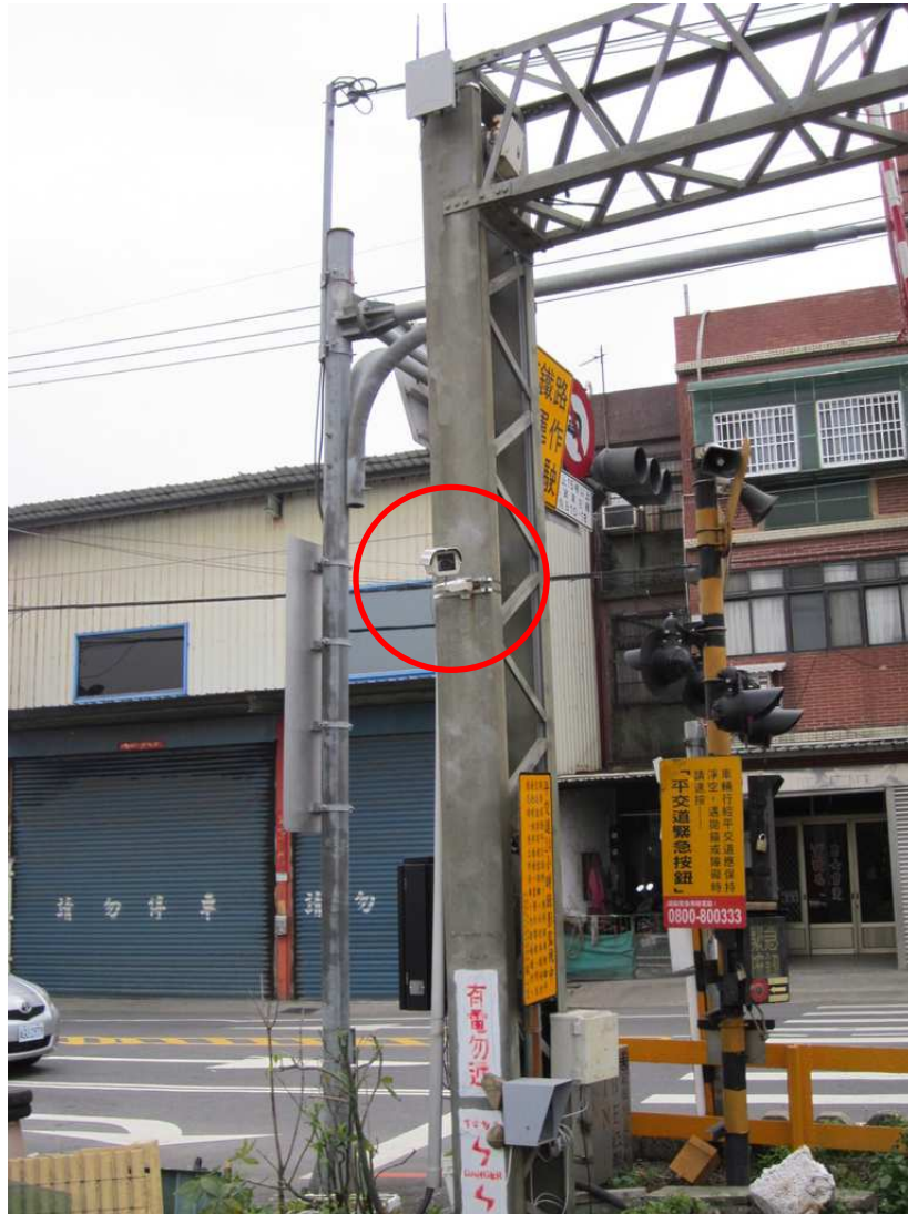
圖5-16 東山科技佈設之網路攝影機 (IP Camera)
