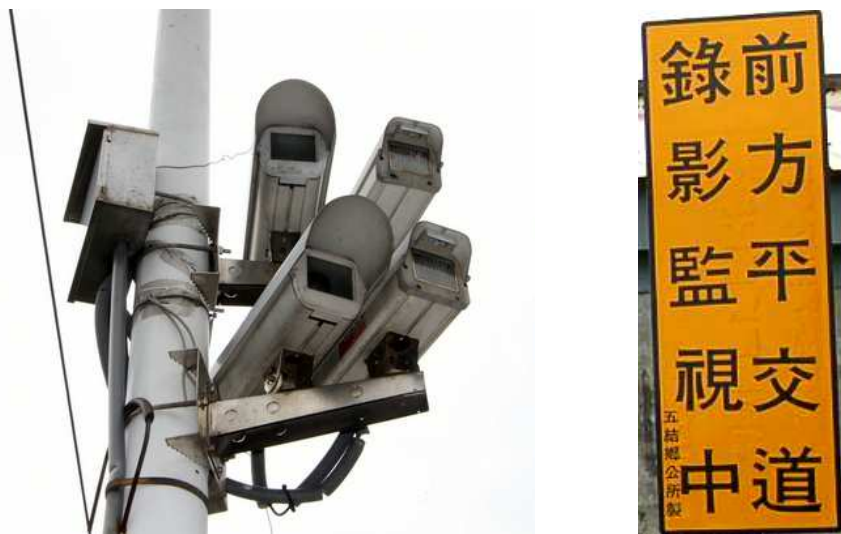
圖2-7 平交道錄影監視設備與警告標誌
